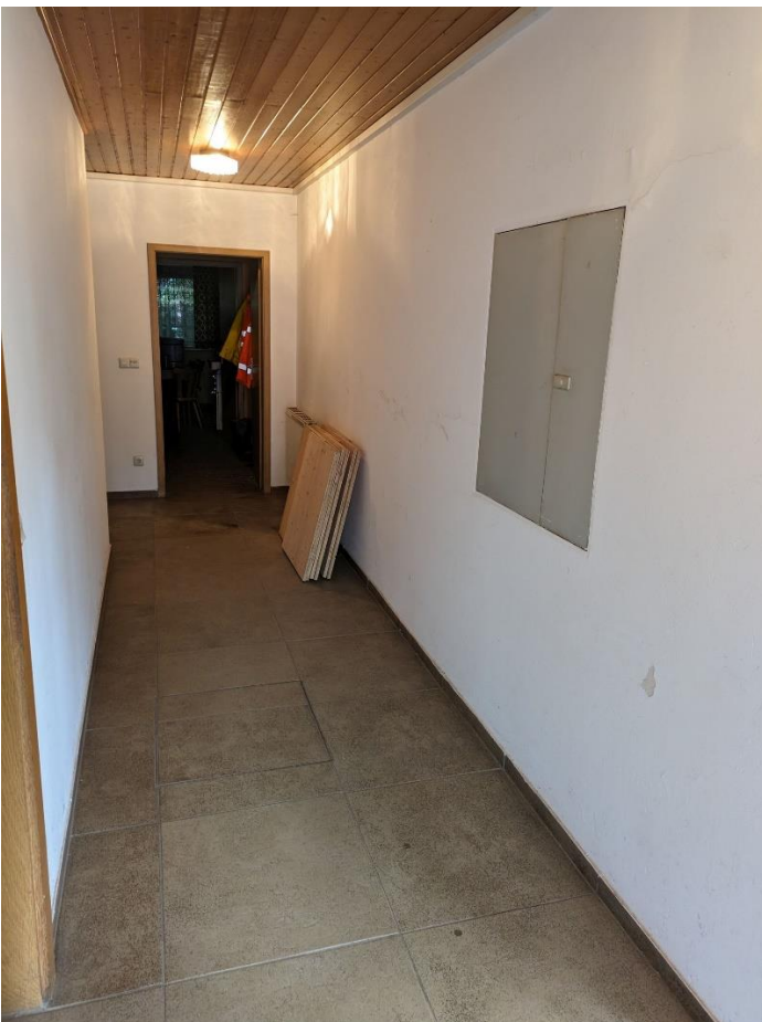
Abb. 4: Alte UV (wird erneuert), Gangbreite: 145 cm
